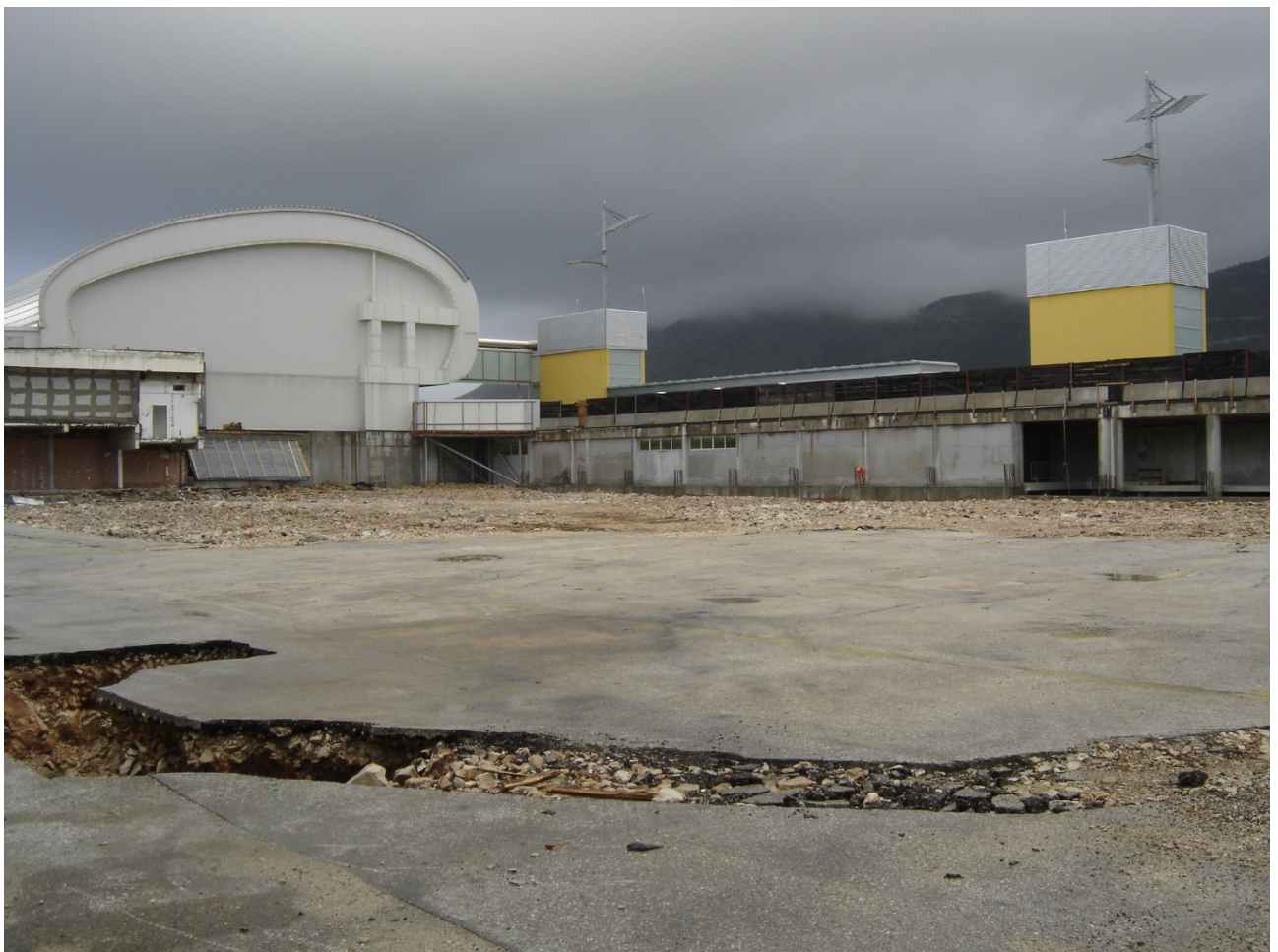
Prilog 26: Gradilište zgrade „C“ - I. faze radova (pripremni i zemljani radovi) (Izvor: Trames d.o.o, listopad 2012.)
