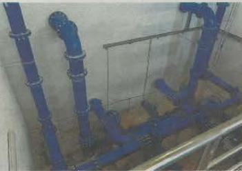
Crpna stanica Seline
